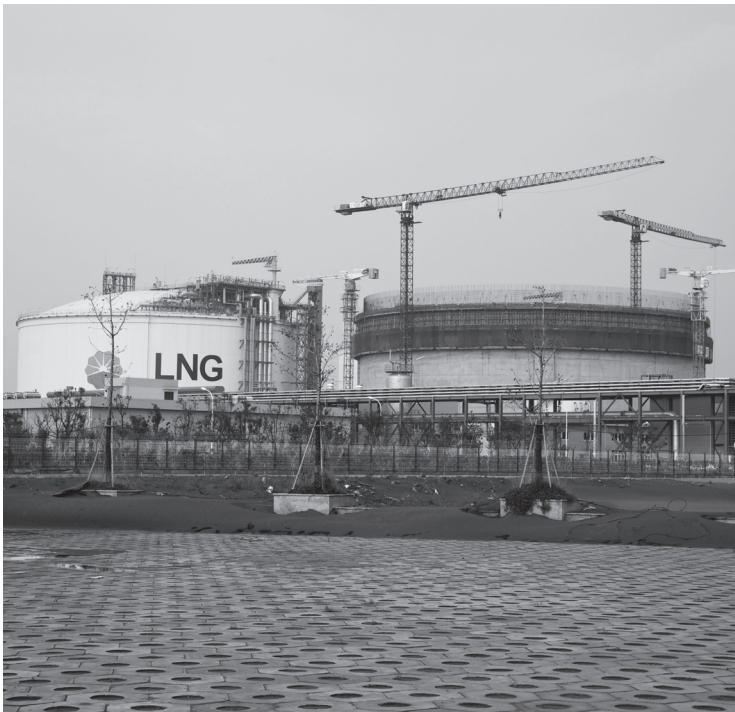
Rudong LNG terminal (courtesy: Simon Q)
